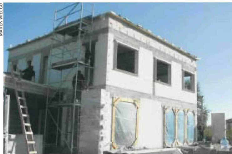
Marzenę Wierchucką do budowy domu pasywnego zachęciły wygrana w konkursie Isovera oraz perspektywa uzyskania dopłaty z NFOSiGW
